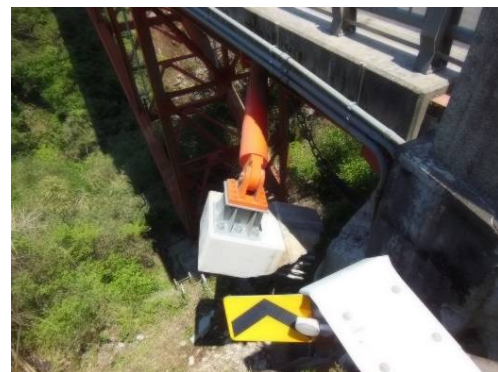
南阿蘇大橋 耐震ダンパー脱落
