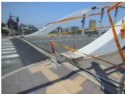
通行止めの白川橋
