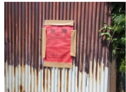
住宅に貼られた「危険」ラベル
