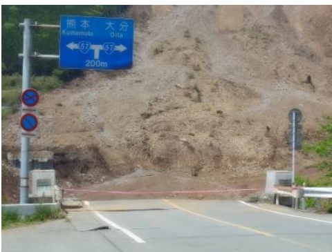
阿蘇大橋付近の崩落 3 (橋台付近)
