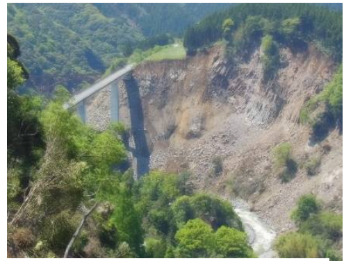
阿蘇大橋付近の崩落 1 (阿蘇長陽大橋付近)
