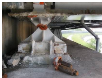
白川橋支承の損傷
