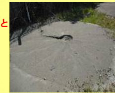
液状化による噴砂跡
