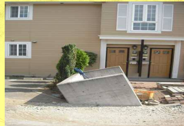
門壁の沈下と傾倒、家屋の沈下 (我孫子市布佐)
