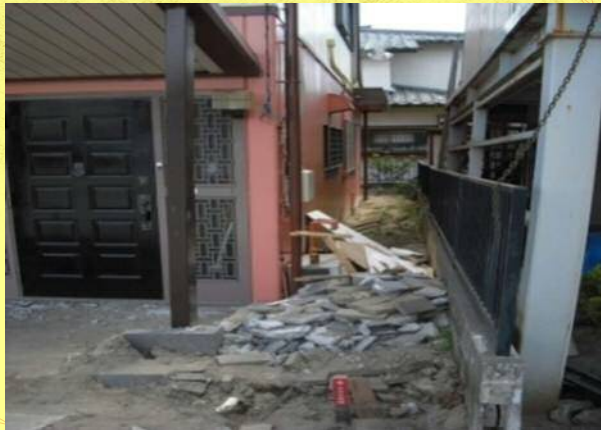
家屋の沈下と施設の破損 (浦安市内)
