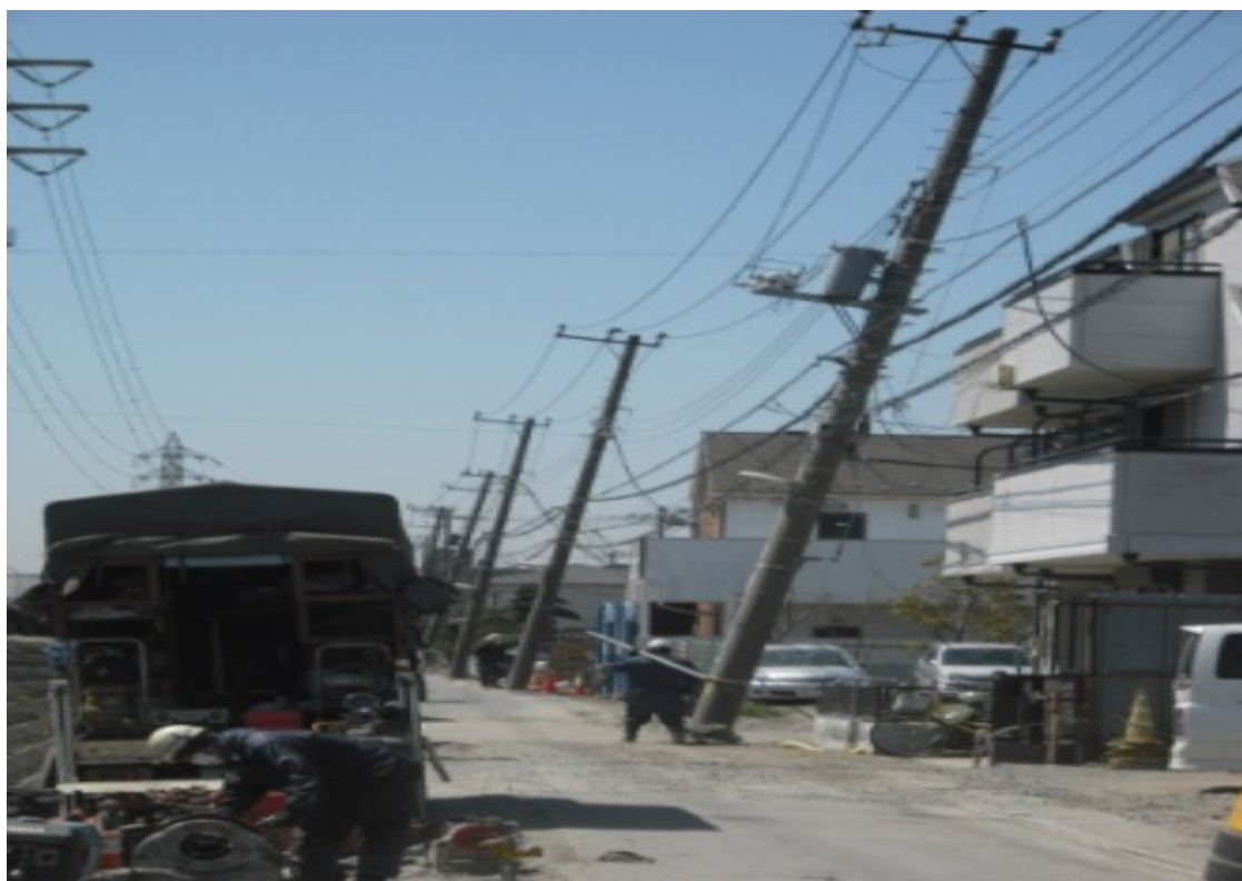
電柱の傾倒状況(今川町)
