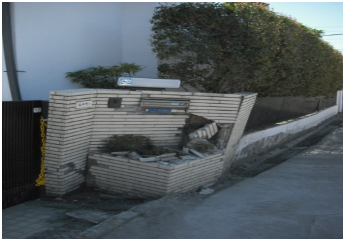
門壁の沈下と傾倒(今川町)
