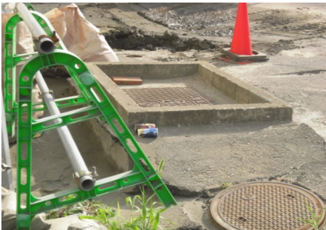
排水弁の浮き上がり状況(船橋三番瀬海岸)(船橋海浜公園内)
