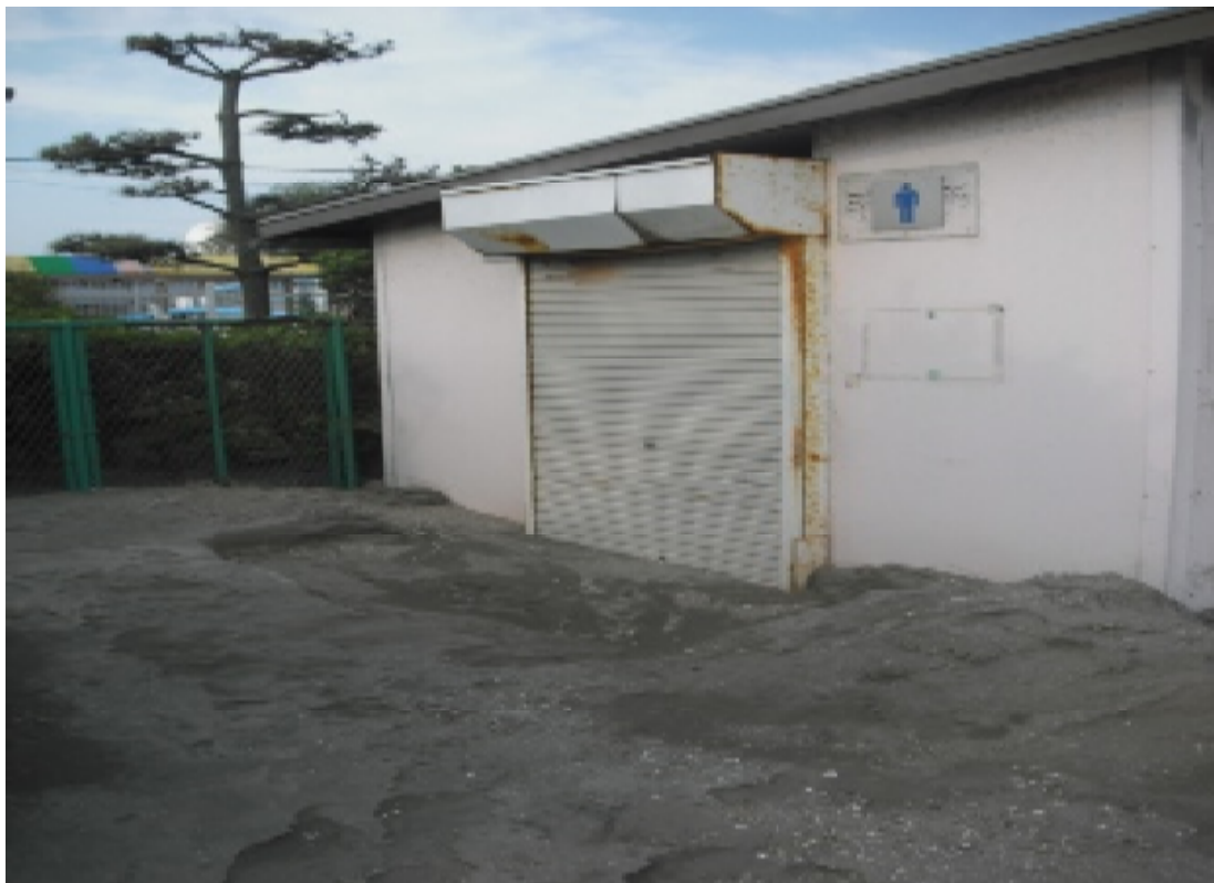
液状化による建物の沈下と噴砂(船橋海浜公園内)
