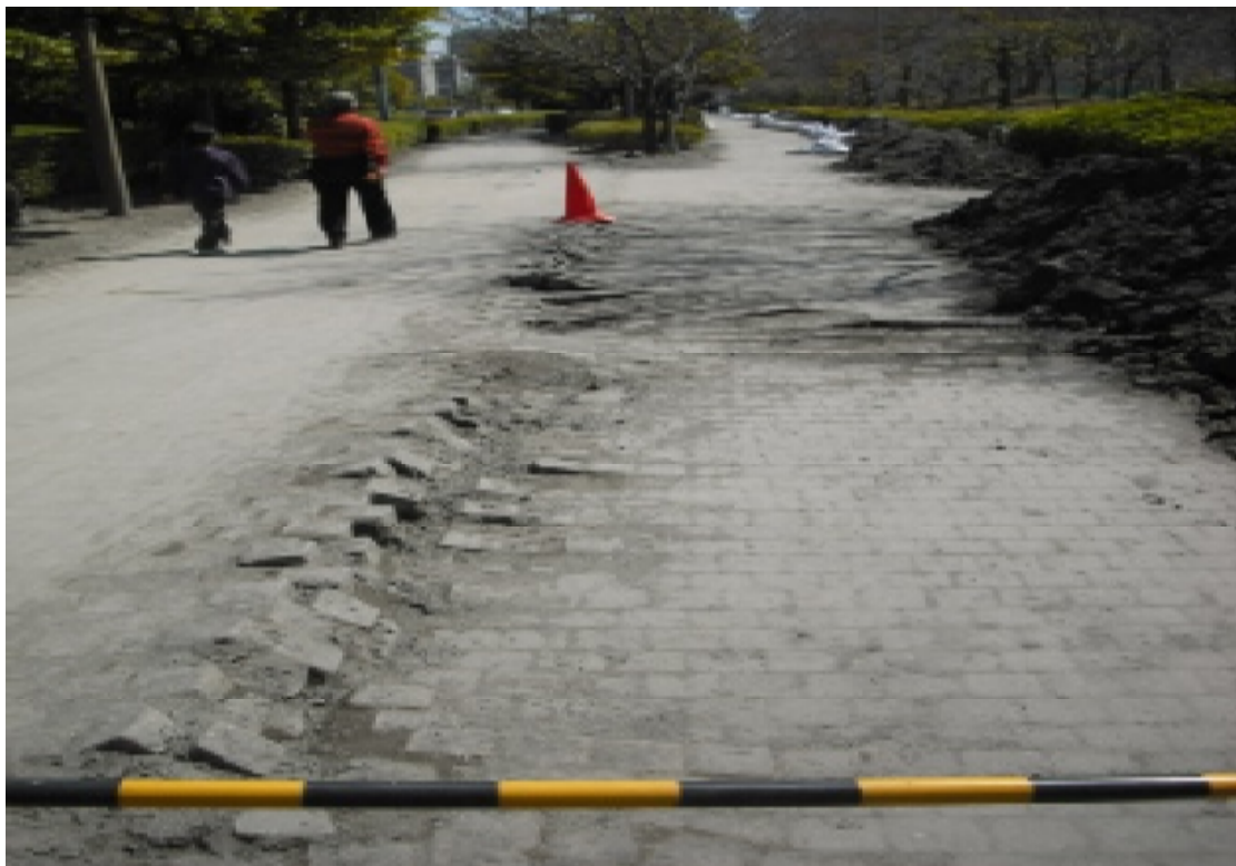
液状化による歩道箇所の路面破損
