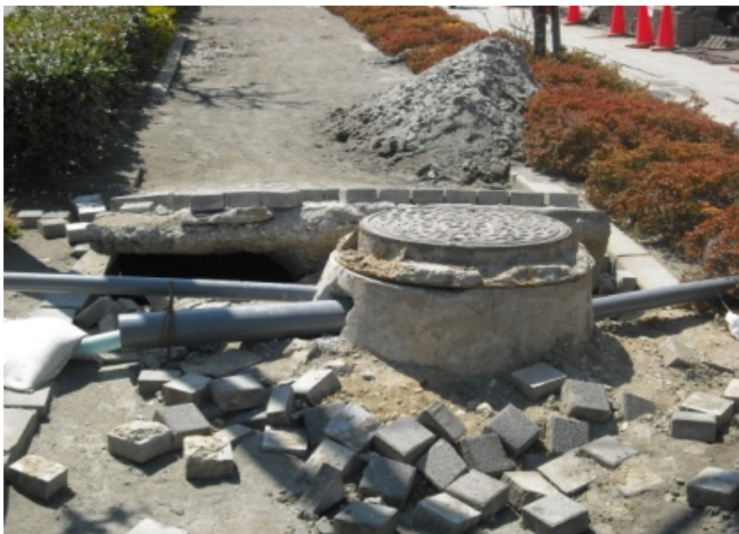
液状化によるマンホールの浮き上がりと歩道舗装の破損
