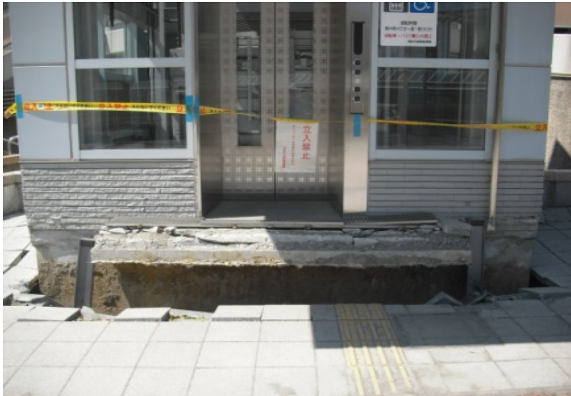
新浦安駅デッキエレベーターと路面沈下
