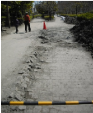
道路(歩道)の段差(浦安市)
