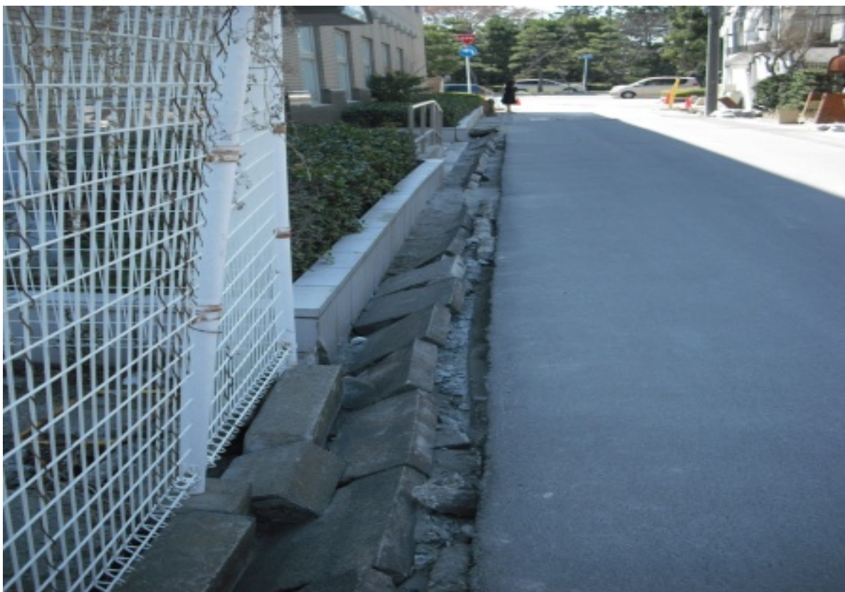
住宅の沈下と道路排水施設破損(今川町)
