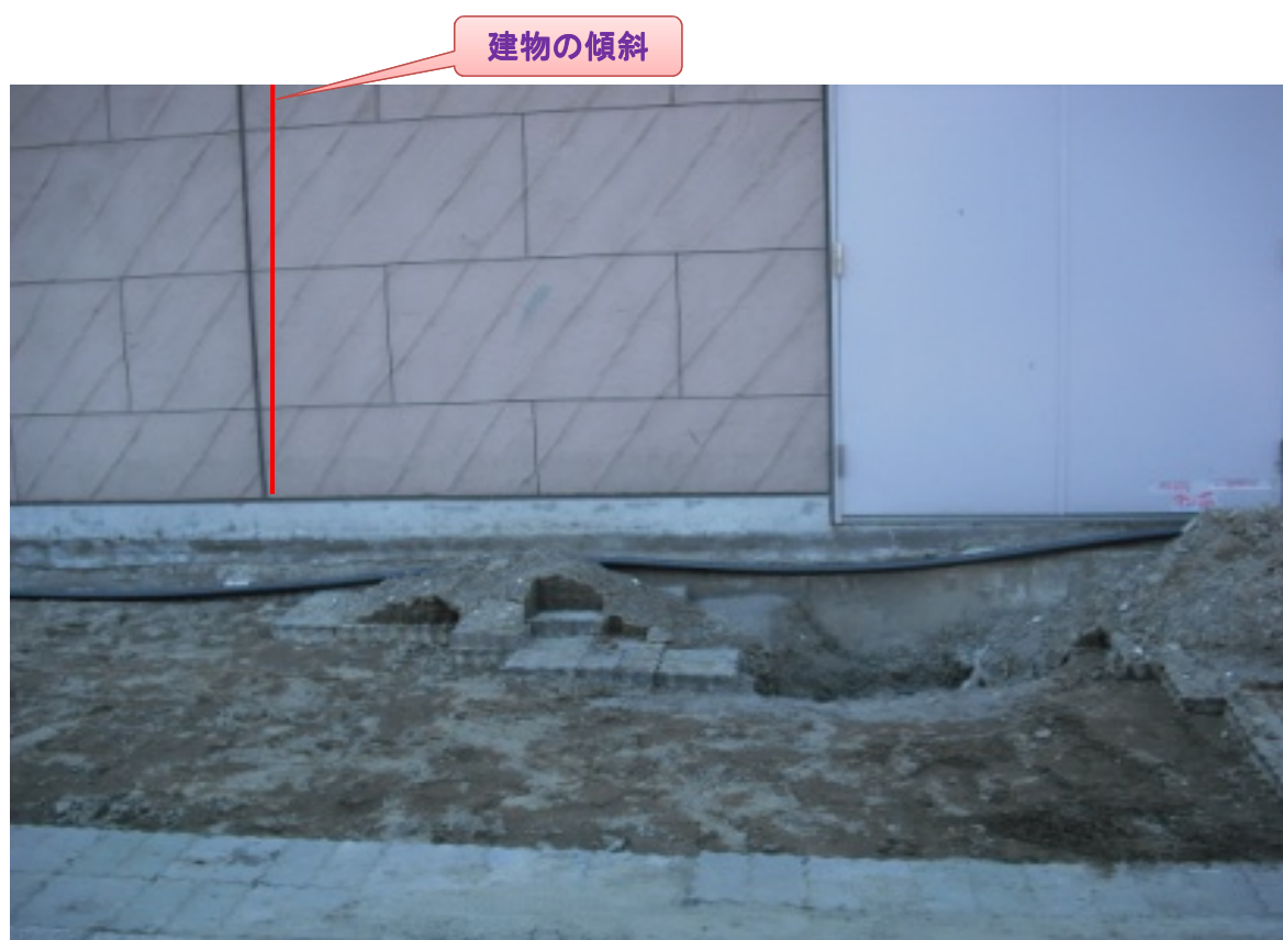
宅地内の地盤沈下と建物の傾斜と基礎露出(今川町)
