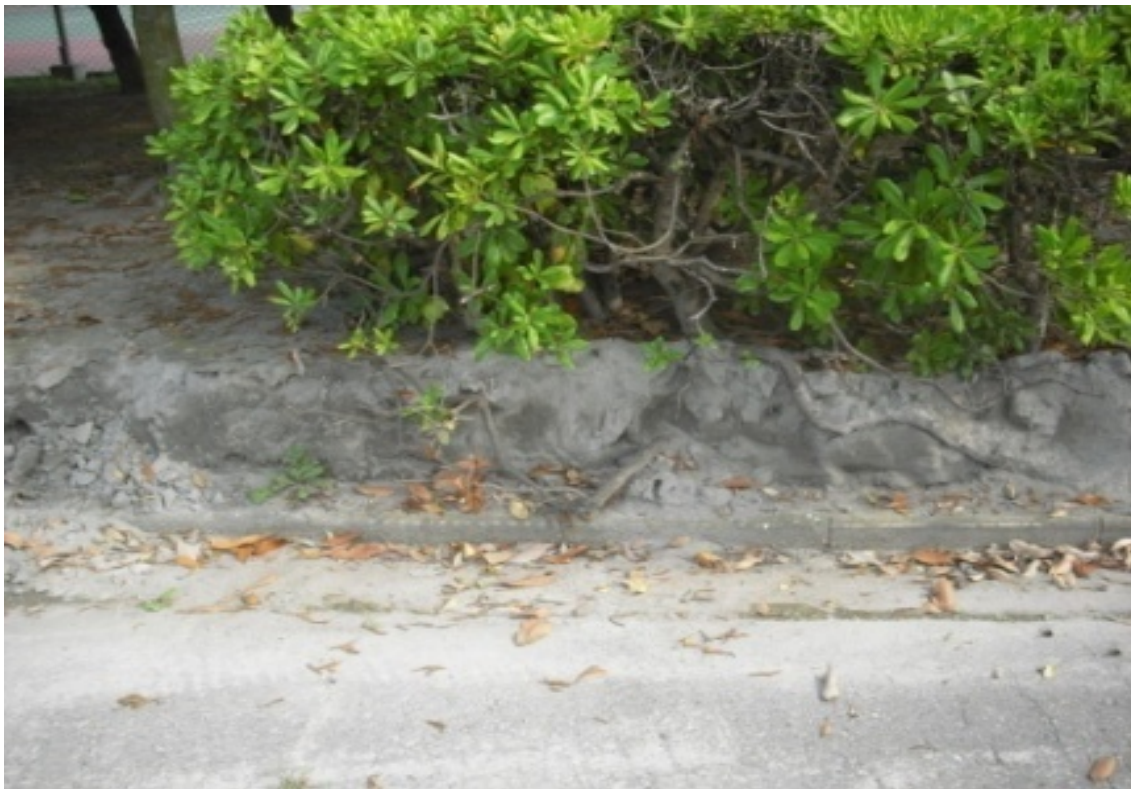
液状化による地盤沈下(35cm)(船橋海浜公園前歩道)
