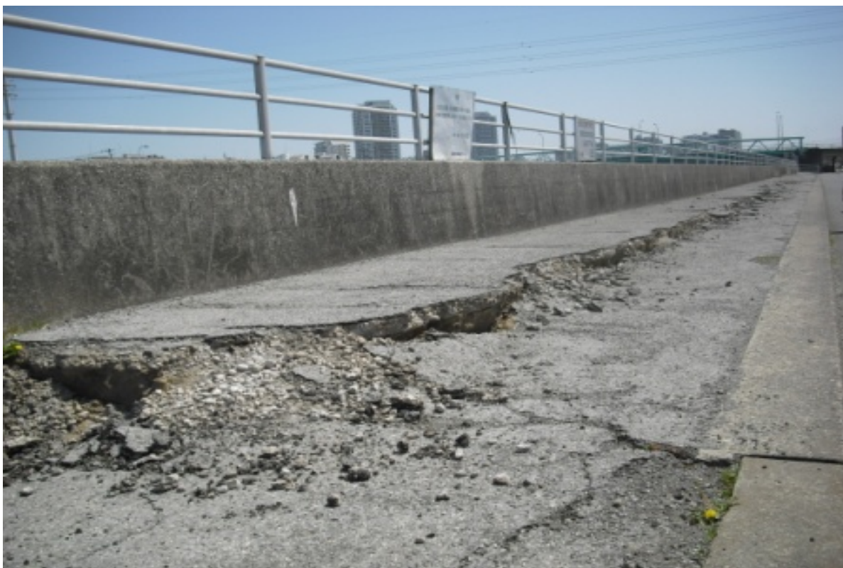
護岸堤防の天端の破損(境川)
