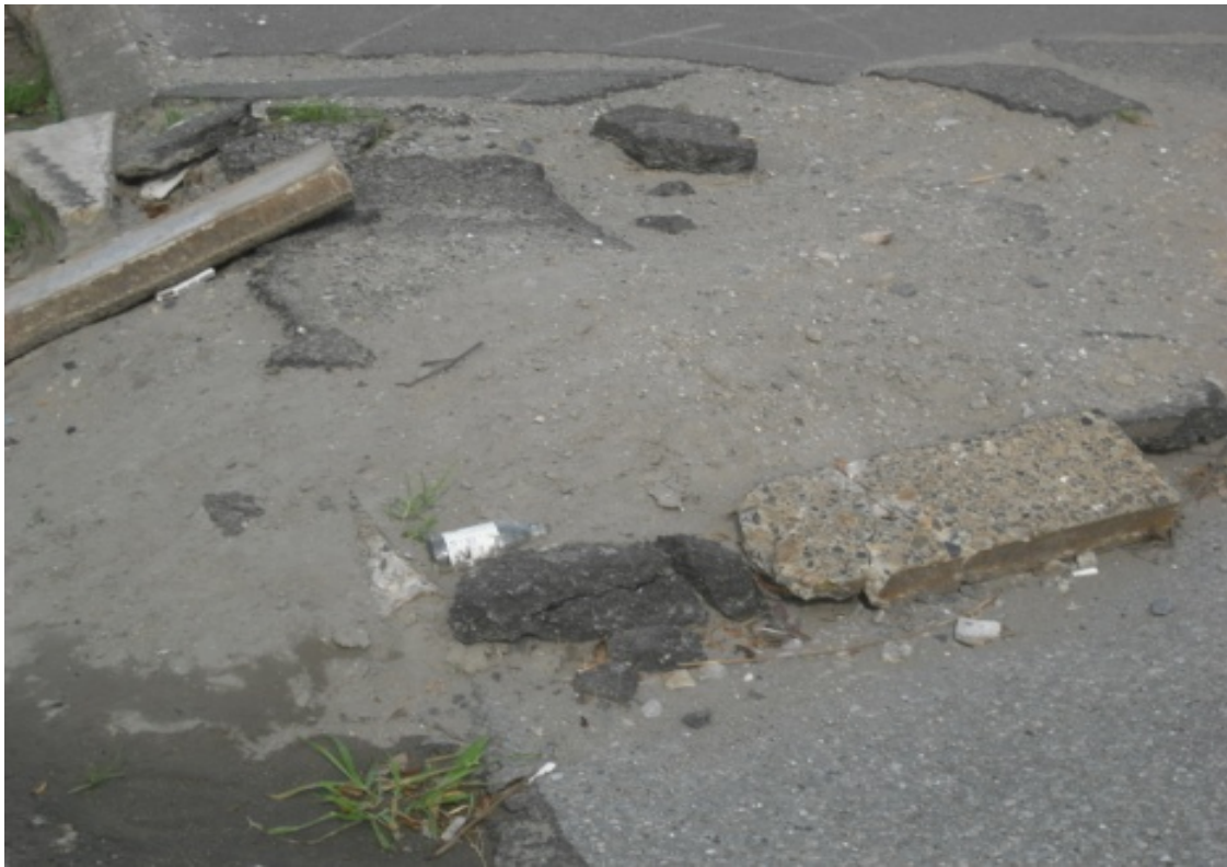
液状化によるCOブロックの散乱(船橋海浜公園前歩道)
