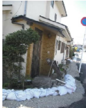
建物の沈下・傾倒(我孫子市)
