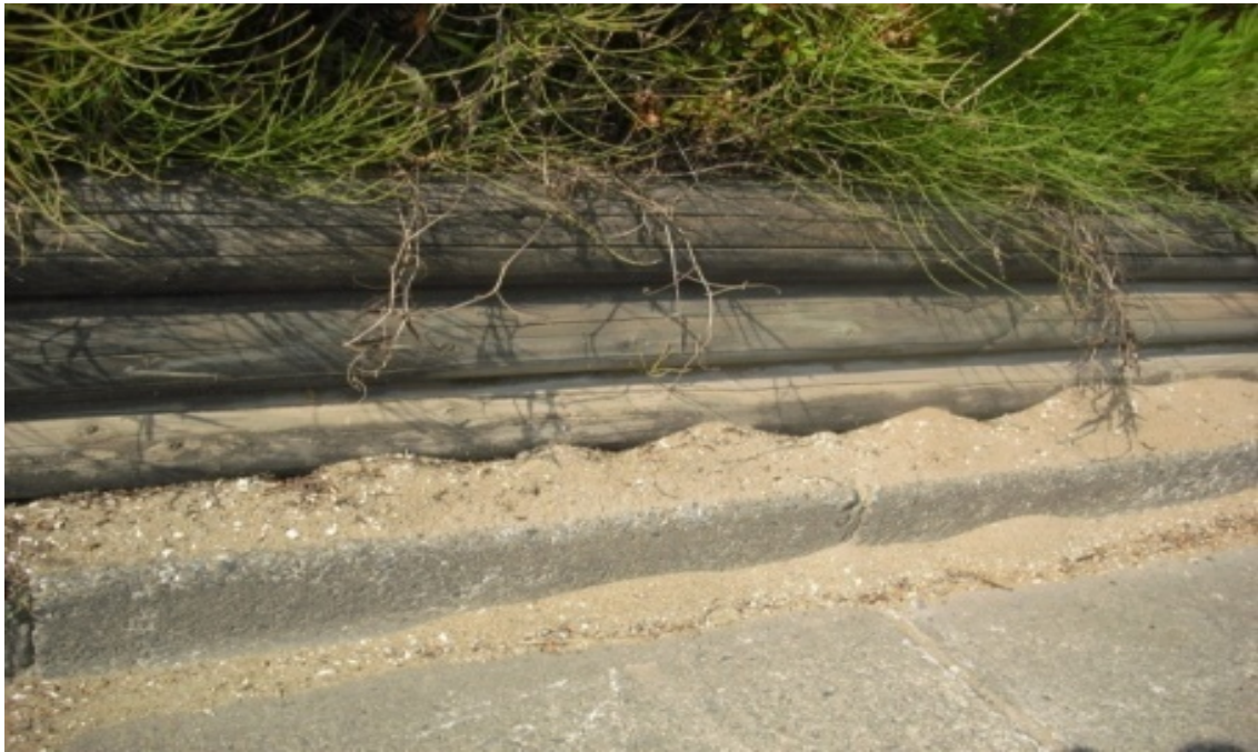
液状化現象噴砂(街渠縁石と植樹帯柵)船橋港付近
