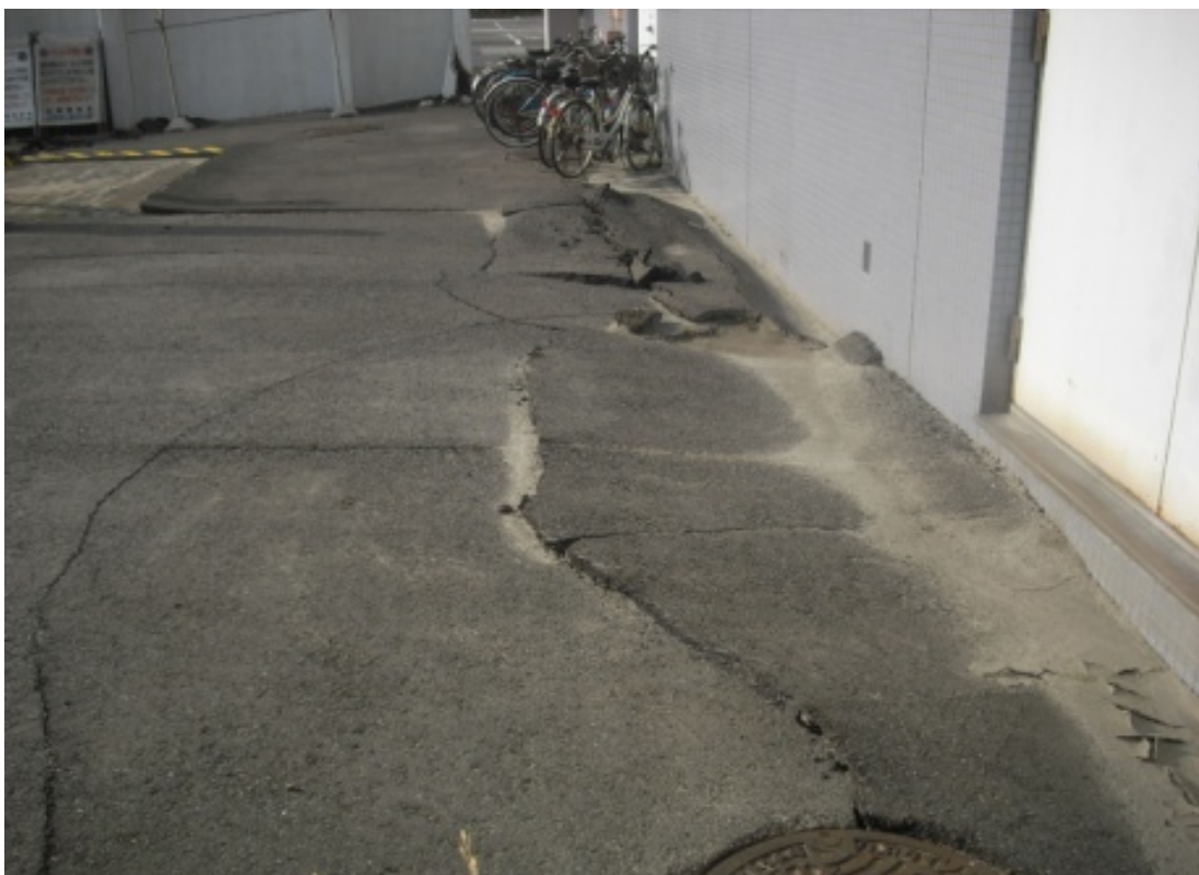
液状化による建物の沈下(船橋海浜公園内)
