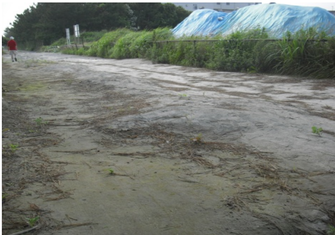
管理用道路の噴砂による砂と隆起(船橋海浜公園管理用道路)
