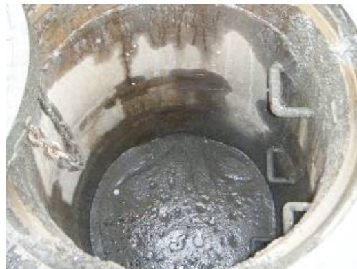
マンホール内の土砂の堆積
