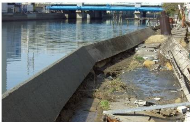
栄町でも護岸に亀裂が
