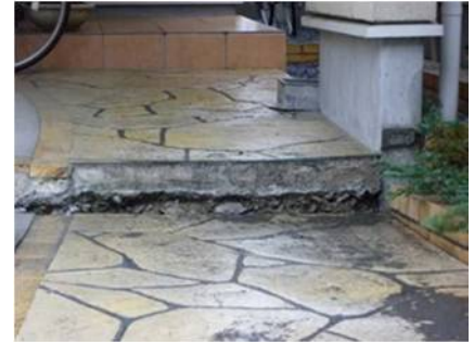
液状化により段差が生じている
