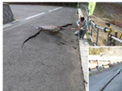
大きな揺れにより、 道路に陥没や亀裂が発生した
