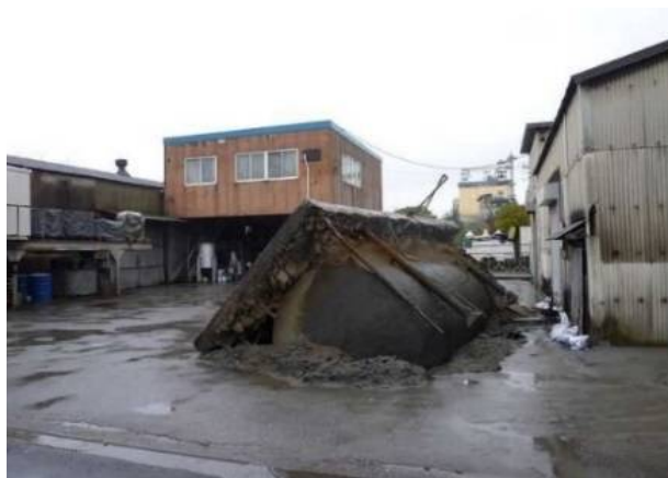
地下タンクの浮上り
