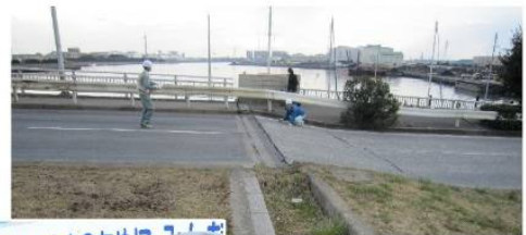
潮見新港大橋も一部損傷した
