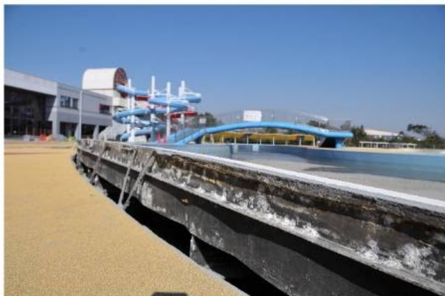
液状化により土台から隆起したプール 三番瀬公園
