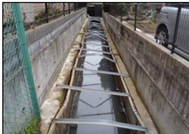
護岸が地盤の側方流動により傾いている ストラッド（梁）が湾曲
