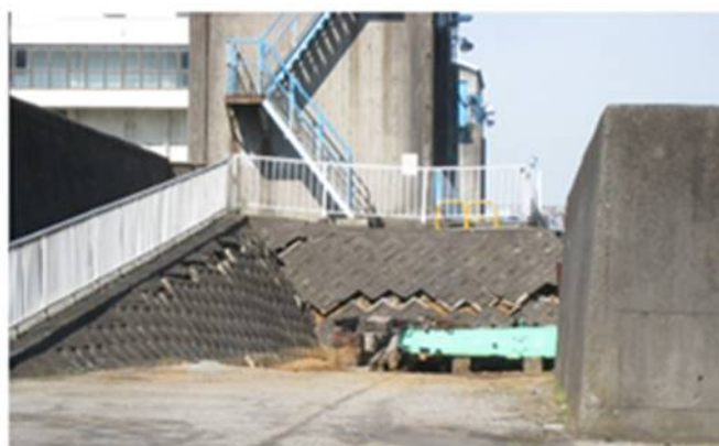
船橋排水機場（水門）が損傷し、歩行者通路が通行止めになった
